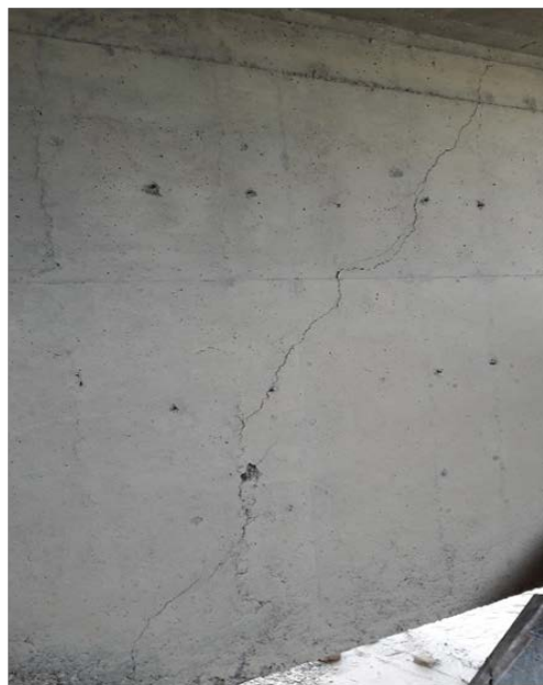
تصویر ۵- ترک سازه ای در تیرهای عرشه
