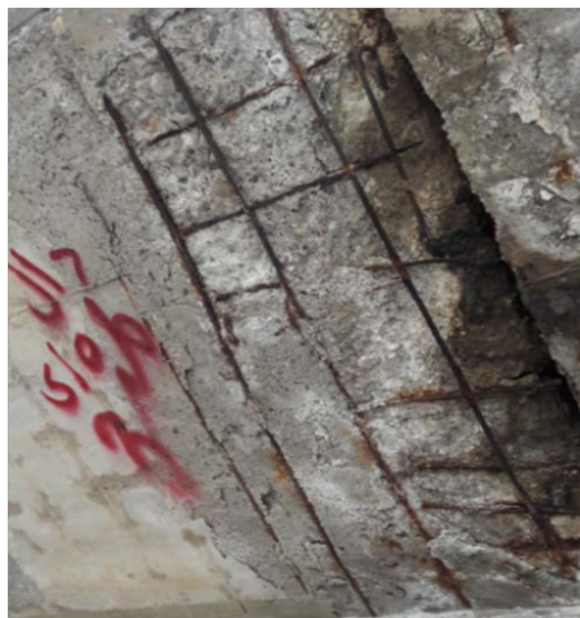
تصویر ۳- نمای تحتانی دال عرشه در یکی از دهانه ها- تخریب بتن و خوردگی شدید میلگردهای خمشی
