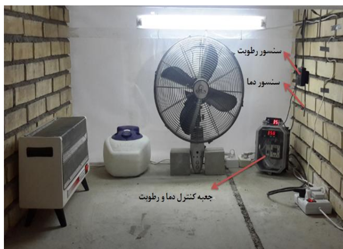
شکل ۴. اتاقک کنترل رطوبت و دما
