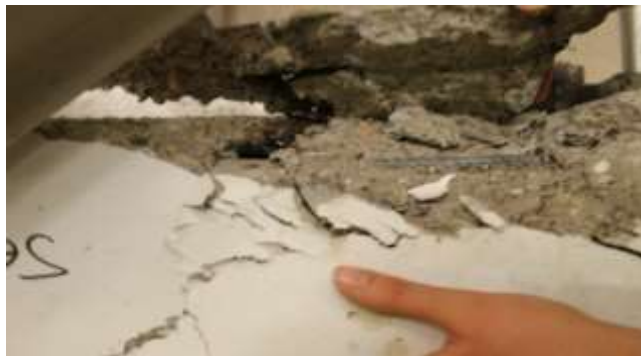
شکل ۱۲. شکست نمونه ترمیم شده با روش خودترمیمی با لوله های یک متری و مشاهده سفت شدن چسب و پر کردن ترکها در داخل بتن و در نتیجه انجام عمل ترمیم
